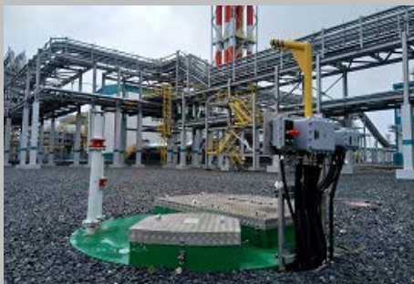
Производство и поставка 30-и комплектных КНС ПАО "СИБУР Холдинг" Западно- Сибирский Нефтехимический комбинат Г. Тобольск
